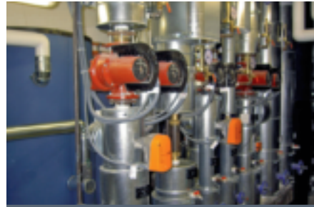
Techniker auf Mallorca können auf die Haustechnik des Hamburger Hotels zugreifen
